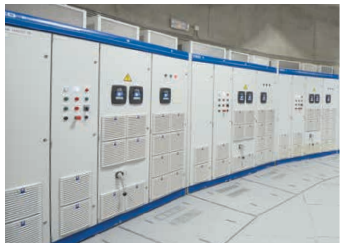
Schaltschränke für die Steuer- und Regelungstechnik
