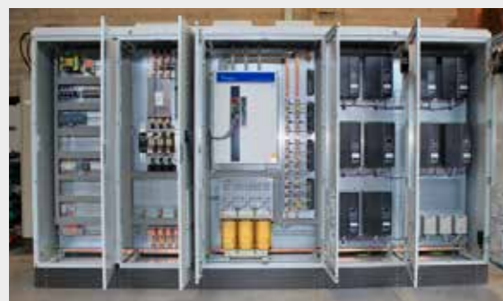
Quadro di comando e controllo per impianto di cogenerazione.
